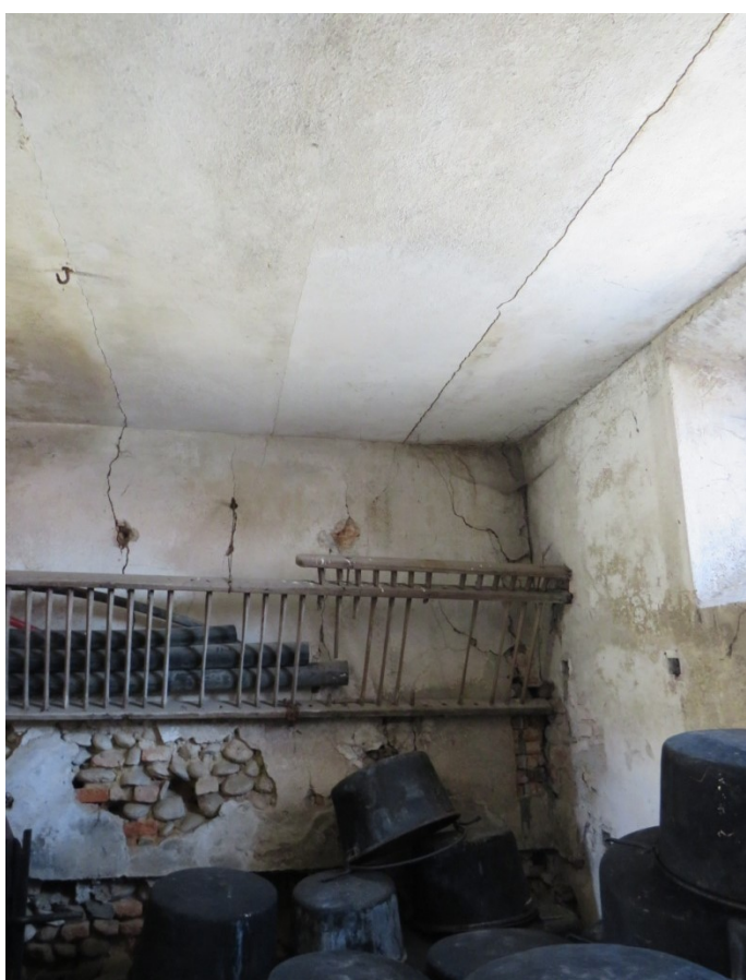
FOTO 17 : Locale sinistro piano terreno muratura da consolidare
